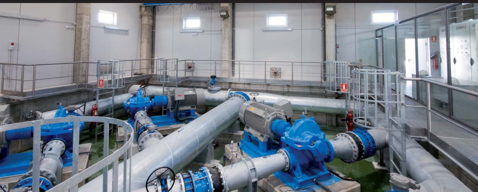
Estación de Bombeo de Agua Depurada de Torreveja, Alicante
