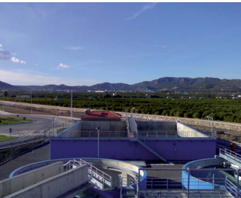
EDAR Polígono Industrial "La Foya" en Quartell, Valencia
